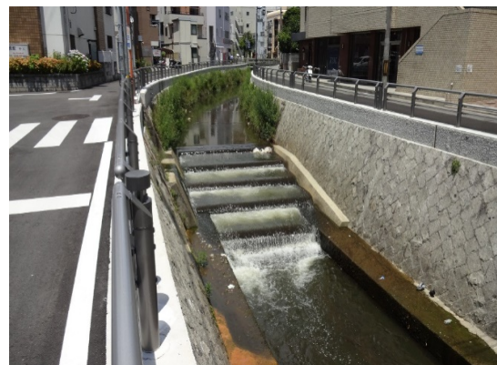
写真 32 津門川魚道の泡
