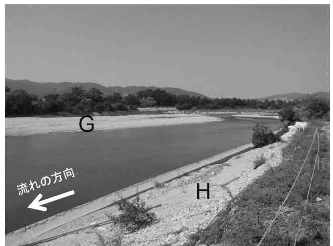
図7 阪急神戸線橋梁上流左岸の河岸浸食状況 (2014年洪水後の撮影, G: 寄洲, H: 河岸浸食)
