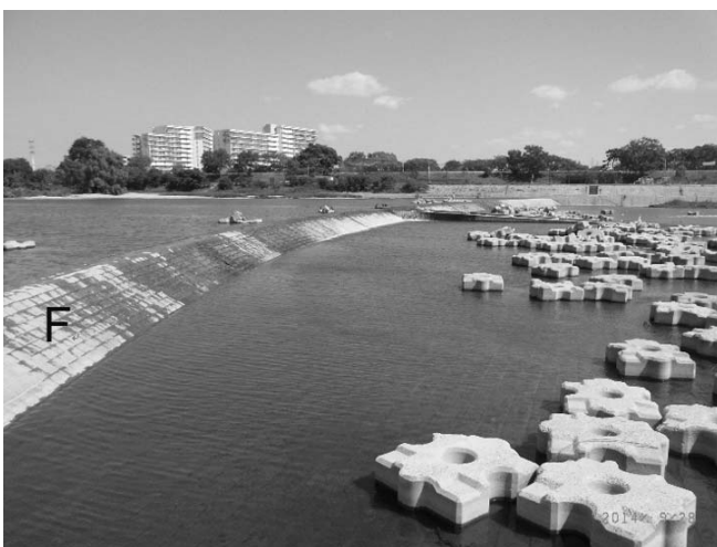
図6 5号床止工 (F) の上流護床ブロックが下流護床工上に散乱した状況 (2014年洪水後の撮影)
