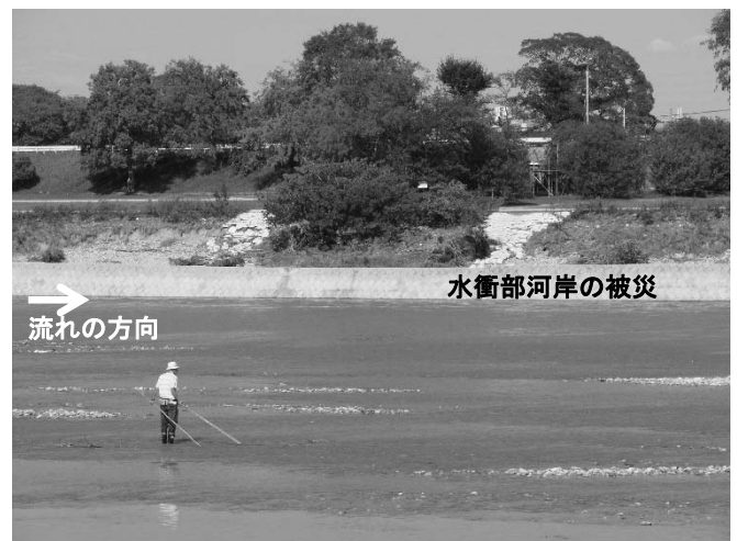
写真4 阪急神戸線橋梁上流左岸の2013年洪水による低水路河岸の被災状況 (2013.09.18撮影)
